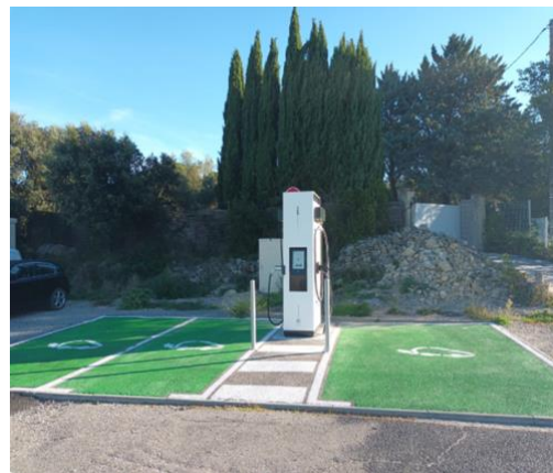
Exemple d'une borne de recharge du réseau « reGARD – la recharge qui nous relie »
